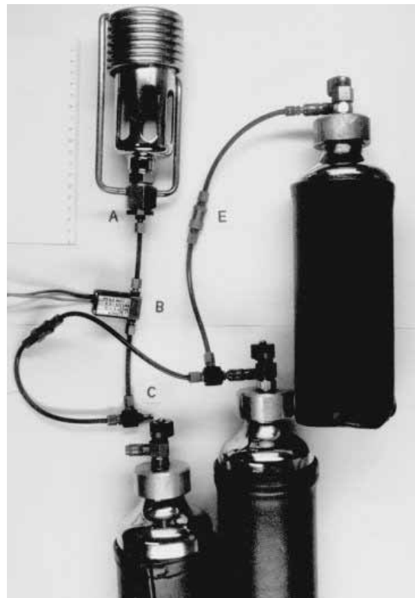
Prinzipielle Installation der Flüssigphasenflaschen für den Hauptbrenner. A = Carat-Flüssigphasenbrenner. B = Bürkert Mini-Magnetventil Type 200. C = T-Stecker. E = Festo Rückschlagventil. Die mit Überdruckventilen ausgestatteten Leichtflaschen sind in Reihe geschaltet.
